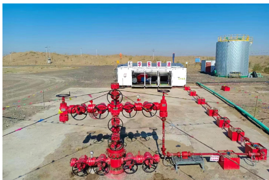
中石化华东液碳 CO 2 注入泵撬
