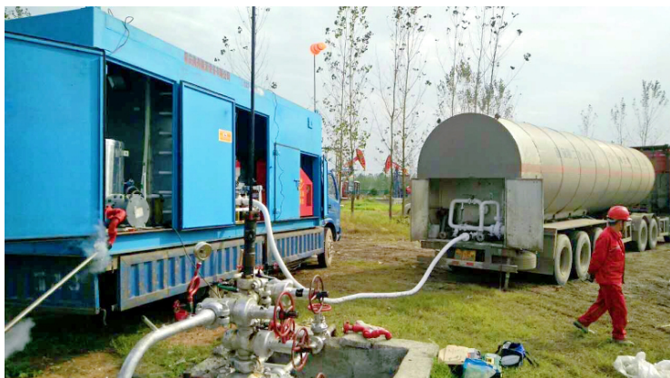
塔里木油田 CO 2 注入泵撬
